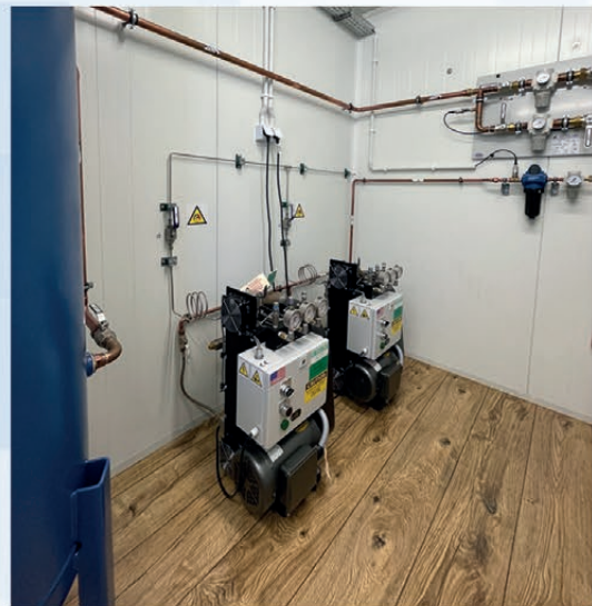
Sprężarki wysokiego ciśnienia
