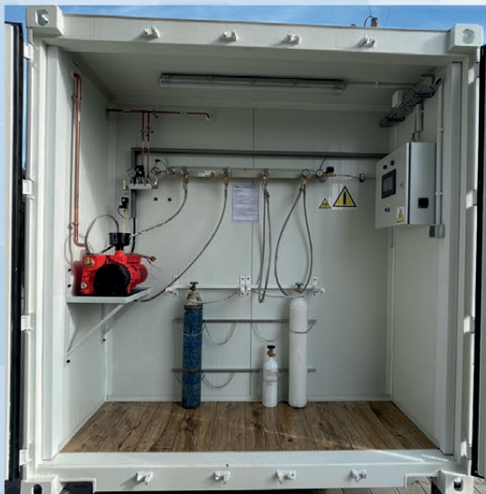
Stacja napełniania butli
