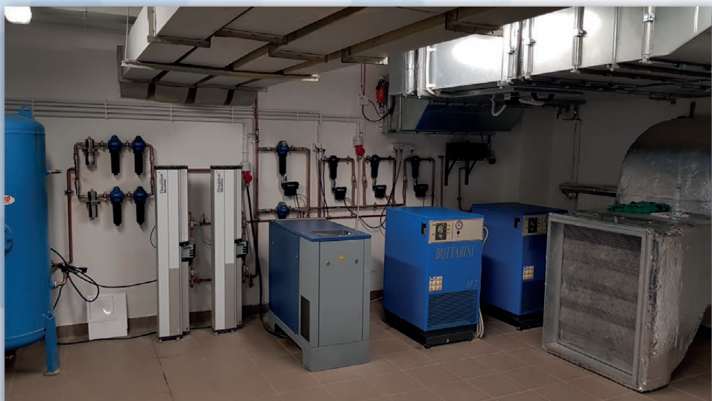
Stacja sprężonego powietrza medycznego
