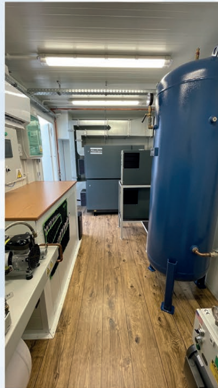
Stacja sprężonego powietrza
