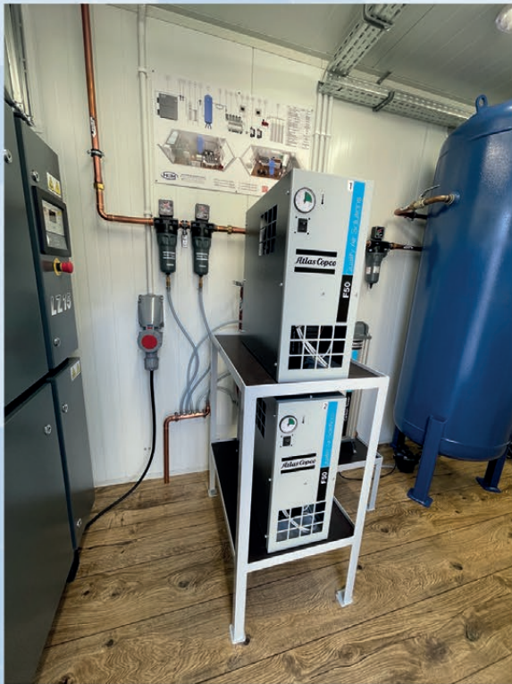
Stacja sprężonego powietrza
