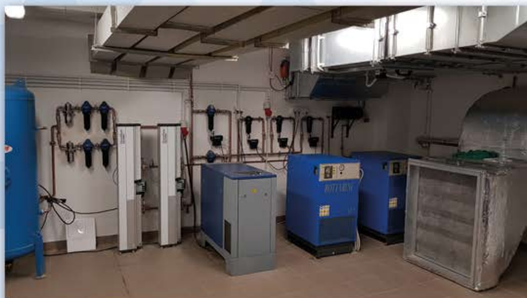
Stacja sprężonego powietrza medycznego
