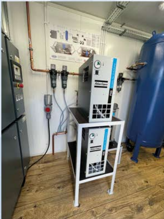
Stacja sprężonego powietrza
