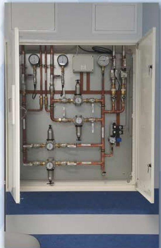
Panel kontroly tlenu
