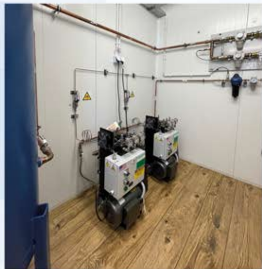
Sprężarki wysokiego ciśnienia
