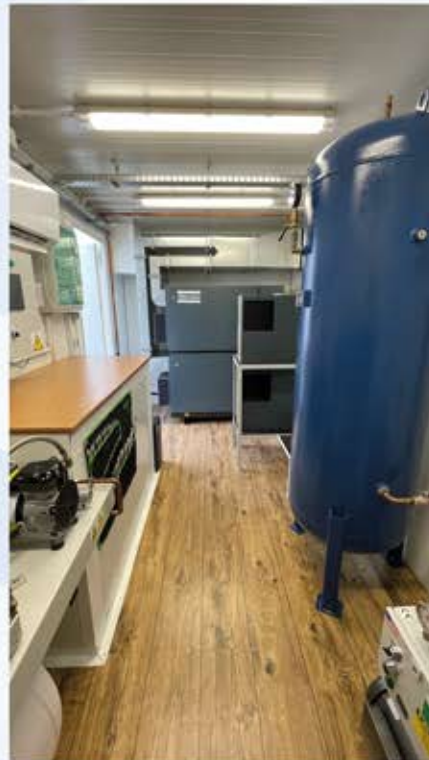
Stacja sprężonego powietrza
