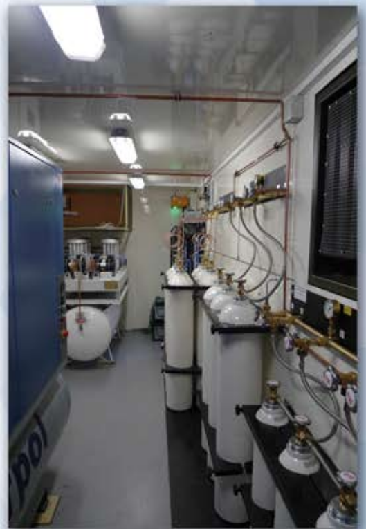
Koncentrator tlenu w kontenerze oraz system napełniania butli
