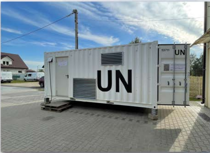
Medyczna stacja kontenerowa
