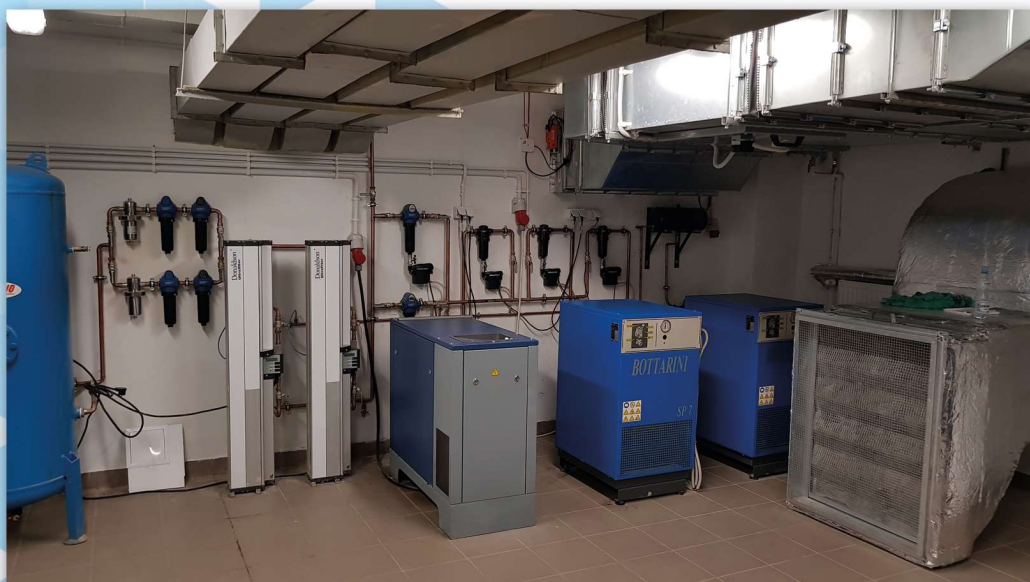
Sprężarkownia powietrza medycznego
